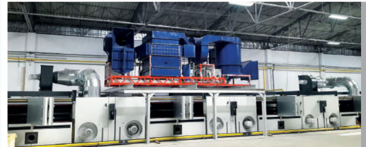
Ram makinesi baca filtrasyon ve enerji geri kazanım sistemi
