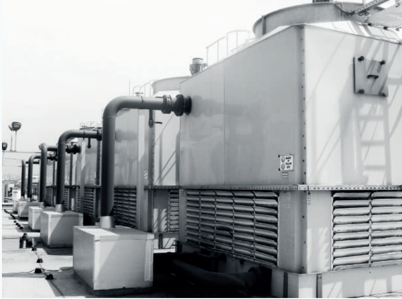
Su soğutma kule grupları
